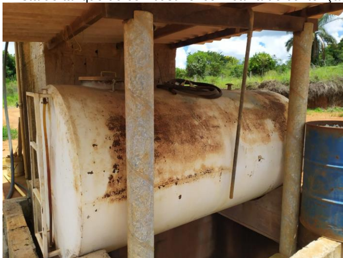
Figura 06: Vista do tanque de combustível com caixa de contenção de 110%.
