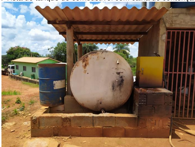
Figura 05: Vista do tanque de combustível com caixa de contenção de 110%.
